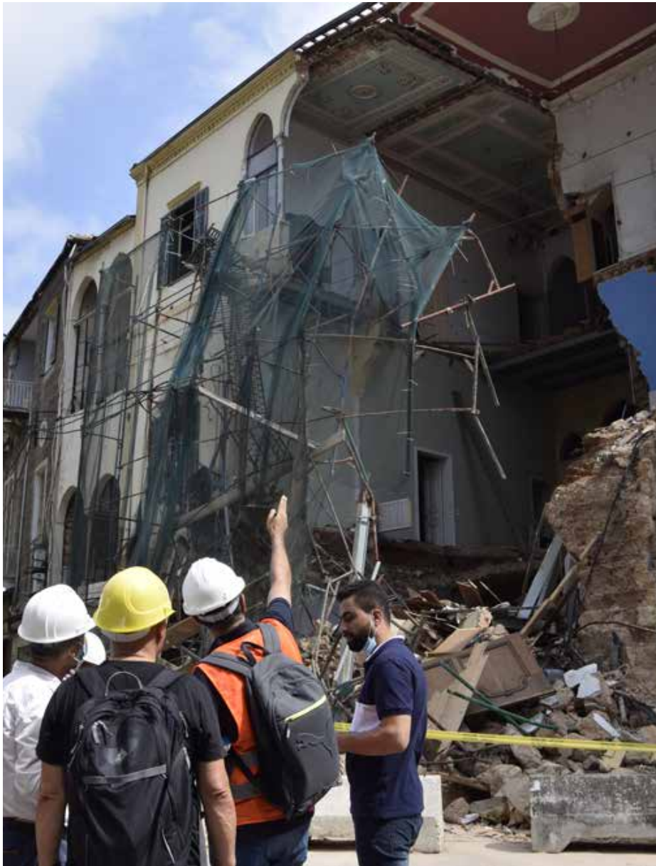
Nach der Explosion im Hafen von Beirut im August 2020 evaluieren auf Denkmalschutz spezialisierte libanesische und deutsche Architekten und Statiker die Schäden vor Ort. (Foto: H. Burwitz/DAI)
